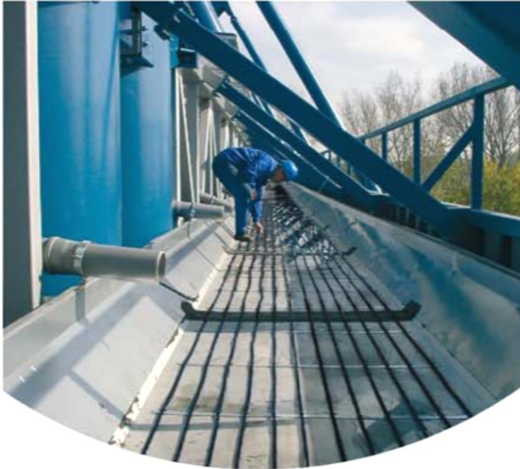
Mocowanie przewodów w korycie dachowym
