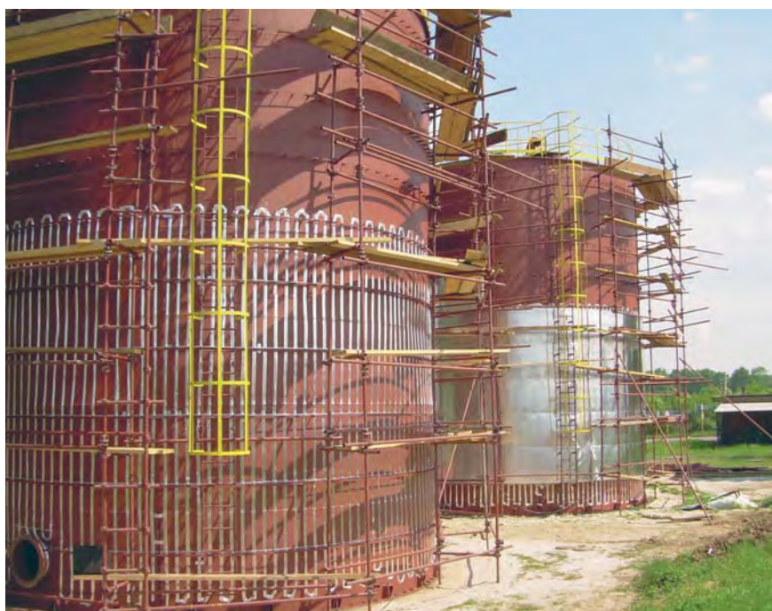
Przewody grzejne zamontowane na zbiorniku
